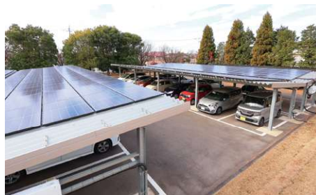
太陽光パネル付きカーポートの設置(茨城県/薬品メーカー)
